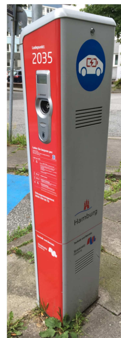
Abb. 8: Ladesäule von Stromnetz Hamburg
